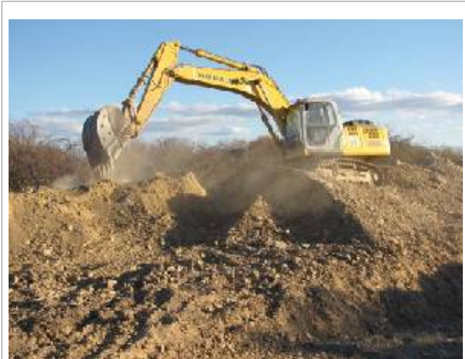
O terceiro passo: a máquina sobe no material depositado ao longo do barreiro trincheira e o remove para mais distante.
